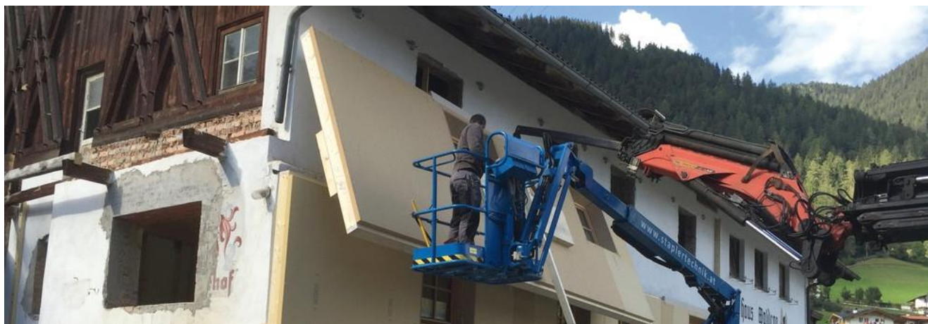
Die 27. Internationale Passivhaustagung fokussiert gute Beispiele für Sanierungen: Der 300 Jahre alte Mayerhof in Tirol erhielt bei der Sanierung nach EnerPHit-Prinzipien eine vorgefertigte Dämmung aus Holzfaserplatten. © Michael Flach
